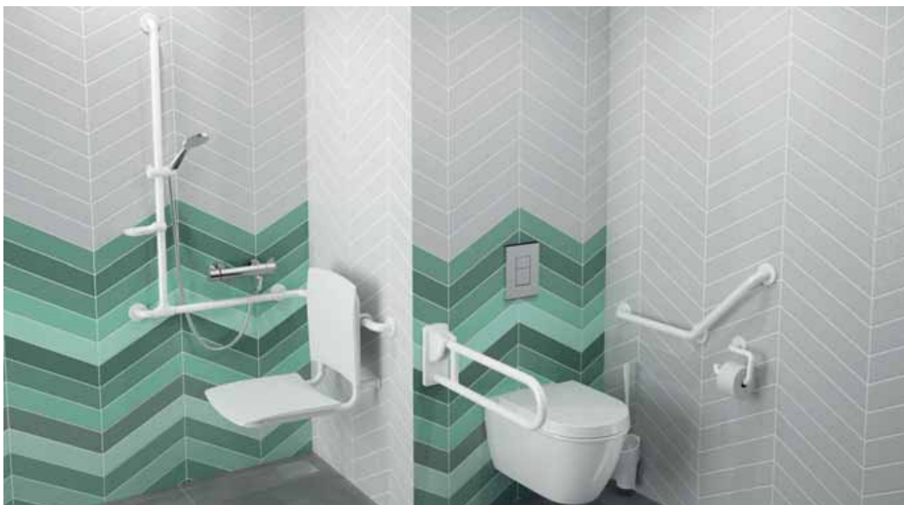
Bâti-support TEMPOFIX 3 avec robinet temporisé de chasse directe TEMPOFLUX 3 564065 + 763000 - Barre d'appui coudée 135° NylonClean 5081N - Barre rabattable NylonClean 5164N - Porte-papier WC en «U» 4081N - Pot à balai avec manche ergonomique 4051N - Siège de douche à accrocher Grand Confort 510300N - Barre d'angle 2 murs avec remontée verticale coulissante NylonClean 5481N - Mitigeur thermostatique SECURITHERM de douche H9741 - Coulisseau 510110 - Porte-savon clipsable 510120N - Douchette 813
